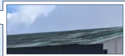
屋根劣化状況（拡大）
