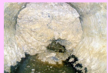
油分で完全に詰まった下水道管
