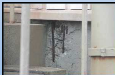
【外壁】(コンクリート剥離)
