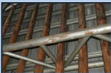
【内部】(錆・劣化)
