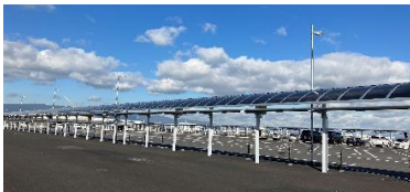
大阪・関西万博ペロブスカイト太陽電池 (提供：積水化学工業株式会社)
