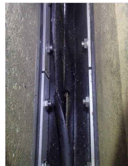
大放水路とポンプ室の ジョイント部の破損
