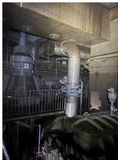
雨水ポンプの状況
