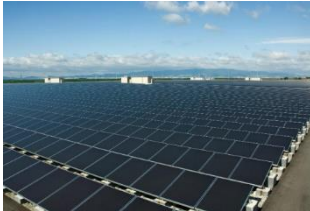
太陽光発電施設
