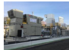
◀水素CGS実証プラント(神戸ポートアイランド)
