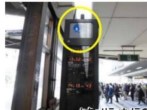
セキュリティカメラの設置
