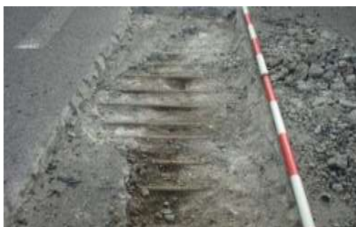
コンクリート床版の輪荷重による疲労損傷
