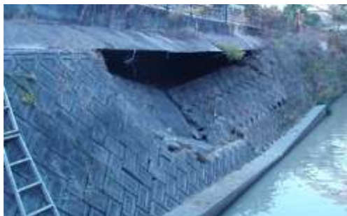
護岸背面土砂流出による護岸倒壊
