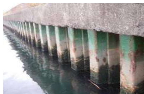
鋼矢板岸壁の腐食
