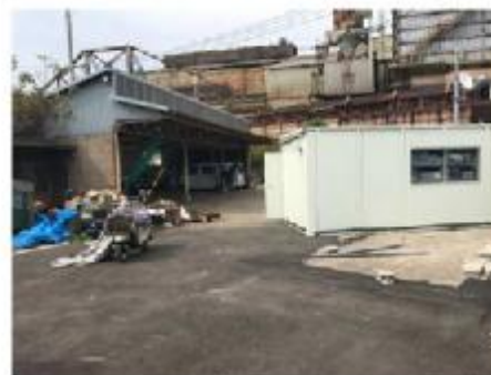
写真1：調査時の堺泉北港湾事務所車庫付近 (右側の白い倉庫が土台から移動)
