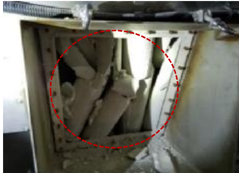
下水道焼却設備破損
