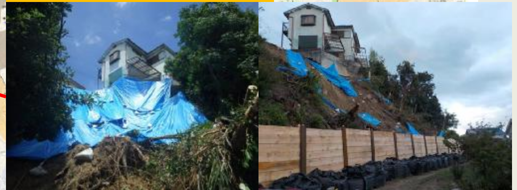
急傾斜地の崩壊（阪南市箱作）
