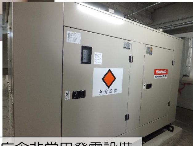
阪南市 庁舎非常用発電設備
