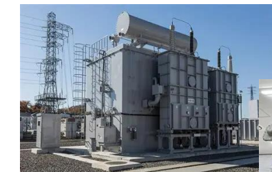
超高圧変圧器
