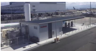
○産業車両用大規模水素供給施設
