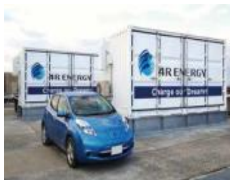
○EVリユース蓄電池
