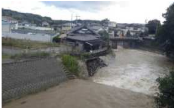
榎尾川護岸崩落
