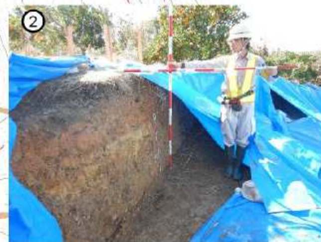
② 地すべりブロック頭部の亀裂 (段差 約1.2m)
