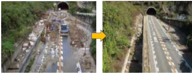
道路上に土砂や流木が流出。全面通行止め措置。 緊急対応業者により崩土等を除去し、速やかに交通開放
