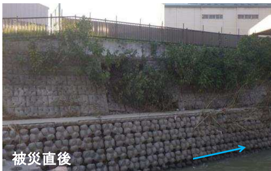
⑮牛滝川 高橋下流左岸（張ブロックを復旧予定）
