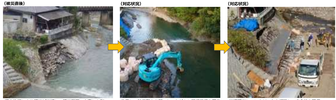
(被災直後) 河床洗掘により護岸が崩壊し、護岸背面の人家にも影響が及ぶ一刻をあらそう非常に危険な状況。
