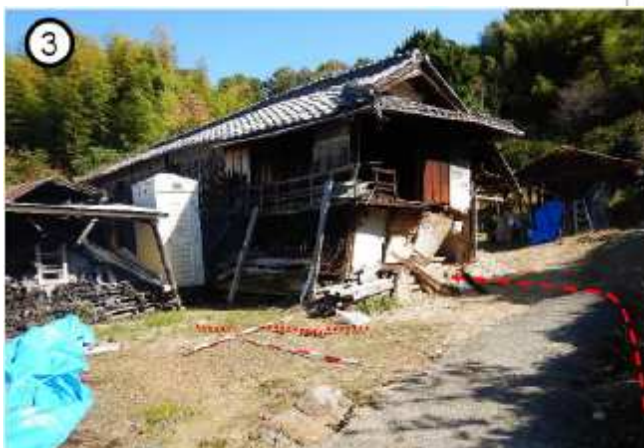
③ 半壊した空き家の状況
