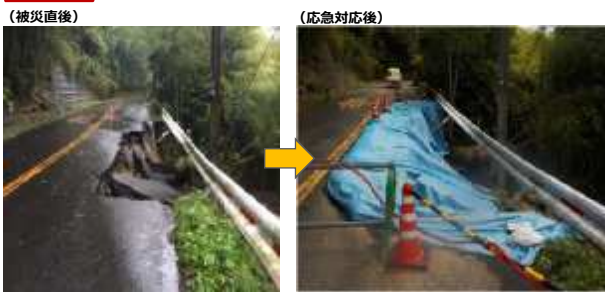
路肩が崩壊し全面通行止め措置 被害拡大を最小限に抑える措置をとり、全面通行止め
