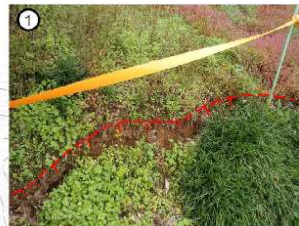
① 地すべりブロック頭部の亀裂 (段差0.1～0.2m)
