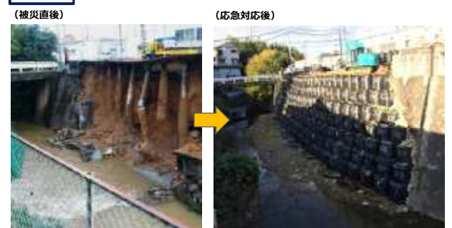
河床洗掘による護岸の崩壊により民有地に影響あり 緊急対応の大型土のうを設置し決壊防止対策を図る
