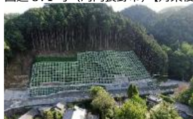
国道 371 号（河内長野市）【対策後】
