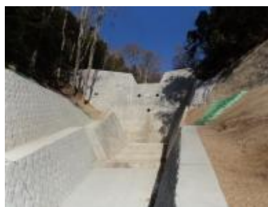
土石流対策事業（池田市 オノ本砂防えん堤）
