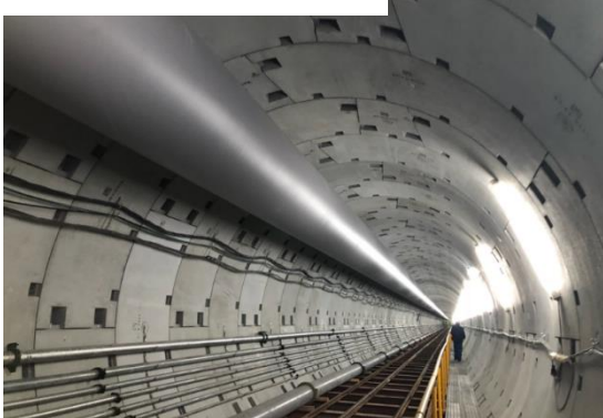
寝屋川北部地下河川
