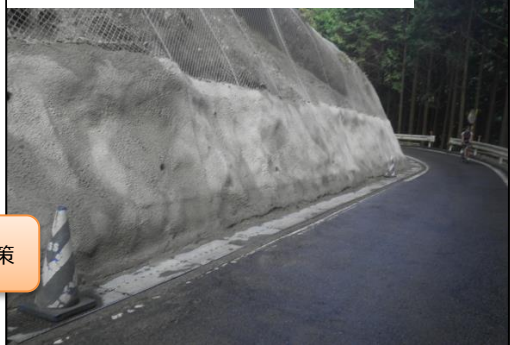
一般国道 480 号（和泉市）【対策後】
