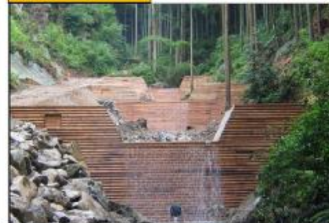
治山ダムの設置により、渓流勾配を緩和し土石流の発生を未然に防止(千早赤阪村)
