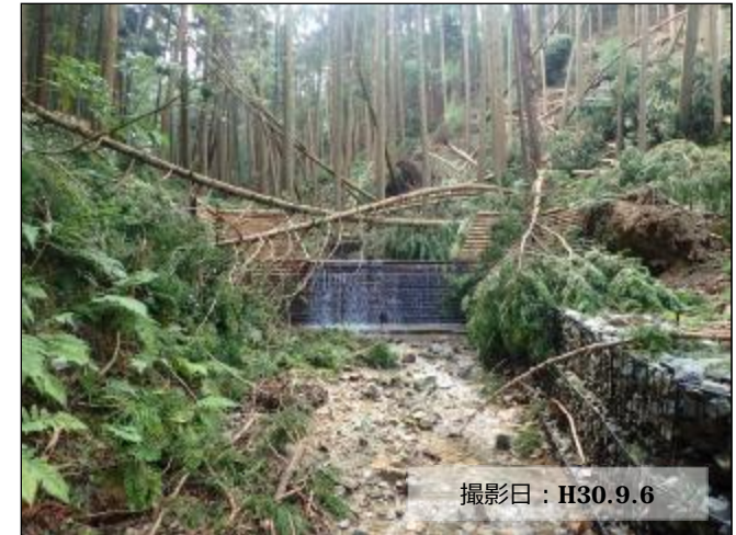
風倒木被害が発生 (H29年度設置の治山ダム)
