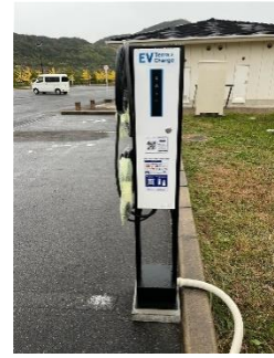
府有施設に設置された充電設備
