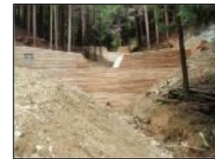
流木の被害を防ぐ治山ダム（千早赤阪村）
