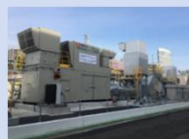
▲水素CGS実証プラント
