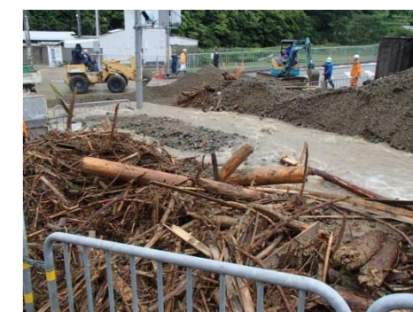
水路に堆積した流木により道路が冠水 (箕面市の事例)
