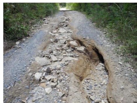
荒廃した作業道 (能勢町の事例)
