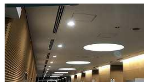
区役所フロアのLED照明
