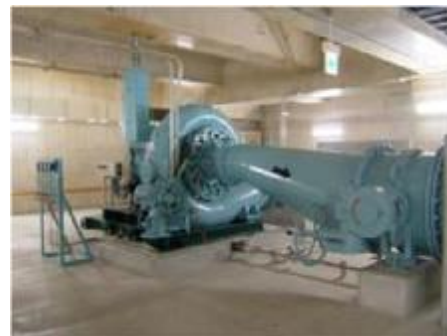
長居水力発電設備
