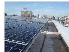
設置例：大阪市立東桃谷小学校
