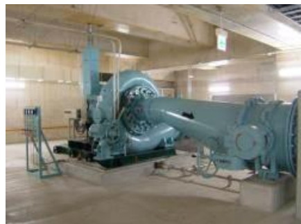
長居水力発電設備
