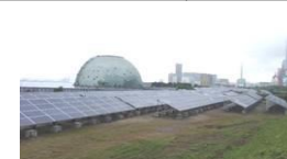
咲洲メガソーラー （大阪ひかりの泉プロジェクト）
