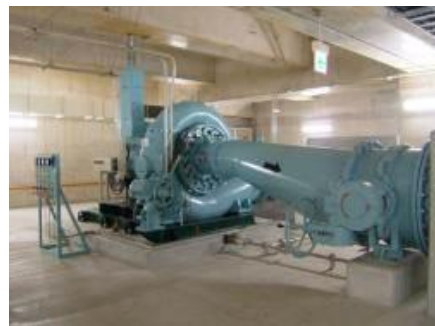
長居水力発電設備
