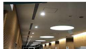
区役所フロアのLED照明
