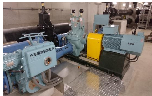
咲洲水力発電設備
