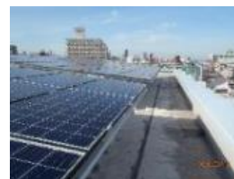
設置例:大阪市立東桃谷小学校
