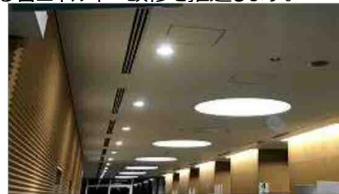
区役所フロアのLED照明
