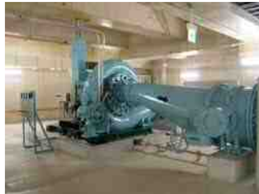
長居水力発電設備
