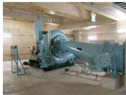
長居水力発電設備
