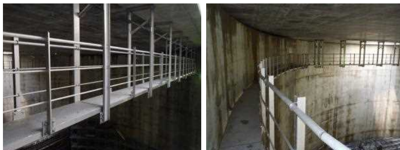
讃良立坑の上部には、点検用の歩廊が設置されています。
