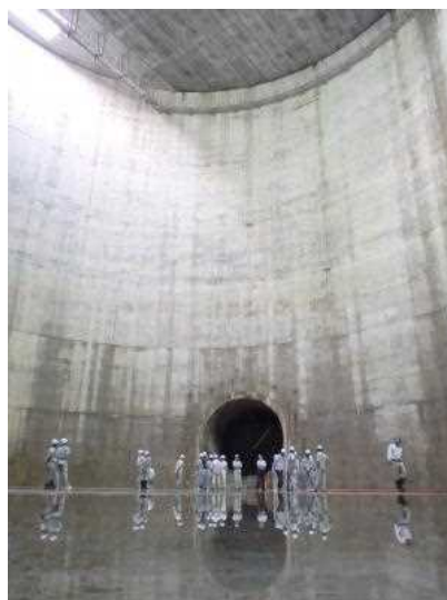
讃良立坑(内径35m、深さ47m)の内部の様子です。奥に見えているトンネルが地下河川(内径5.4m)です。
