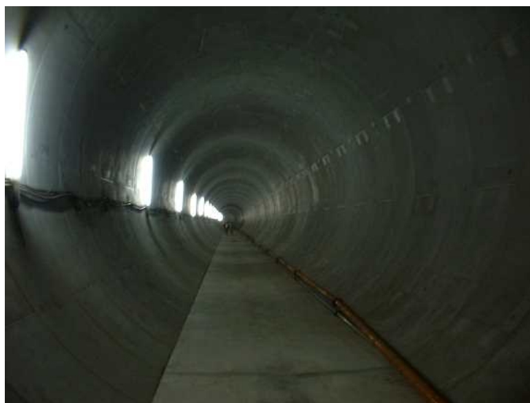
貯留施設として供用済の地下河川の内部 (古川取水立坑から北島立坑の区間は内径約5.4m、延長約1.7km。貯留量は約4万立方メートルです。)
