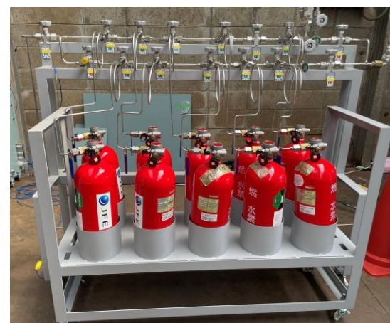
水素充填架台
