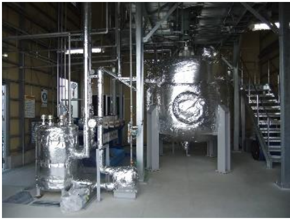
定置型水素製造装置
