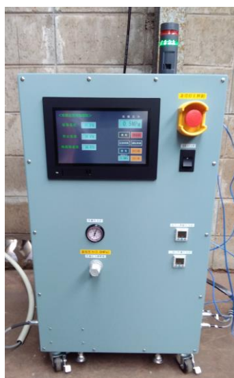
制御システム
