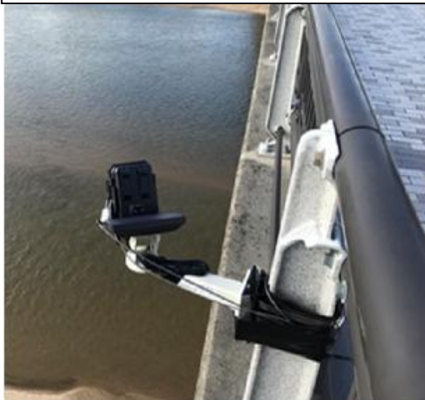
カメラの設置状況（木津川）
