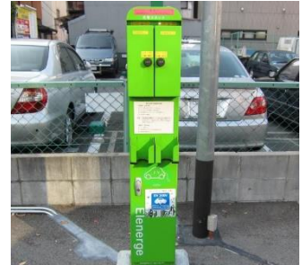
図4-3-2 電気自動車の充電設備
