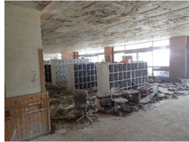
平成30年7月豪雨の被害
