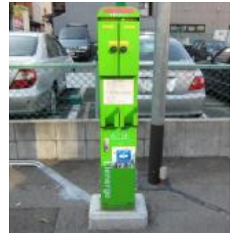
図 4 - 3 - 2 電気自動車の充電設備
