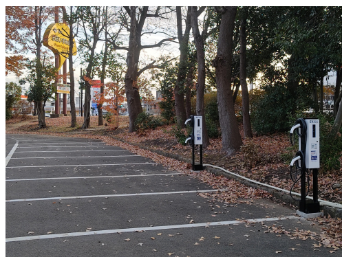
公共施設へのEV用充電設備の設置
