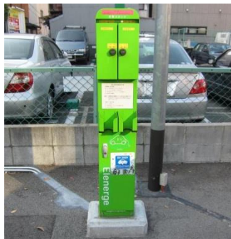
電気自動車等の充電設備
