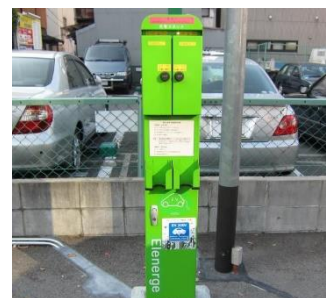
図4-3-2 電気自動車の充電設備
