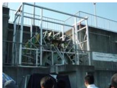
北部水みらいセンター 小水力発電実証実験
