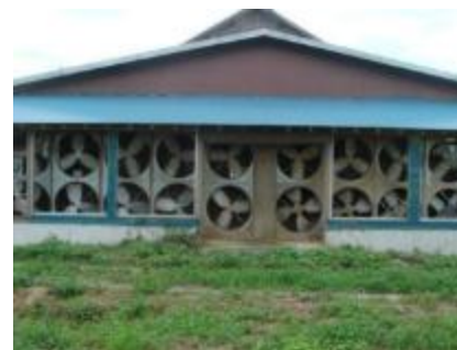
畜舎壁面の換気扇
