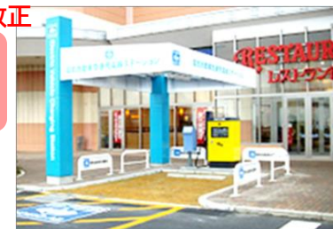
商業施設の来客用駐車場で充電設備(イオンモーターリンクうす南店の急速充電設備)
