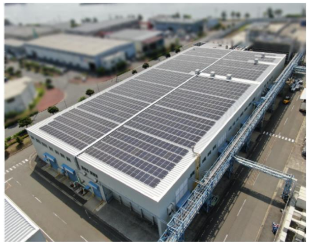
増強した太陽光発電設備
