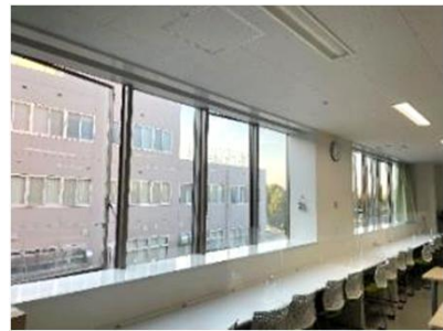
カンファレンス室の窓に導入されたLow-E複層ガラス
