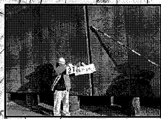
神崎川H30-1 護岸の損傷
