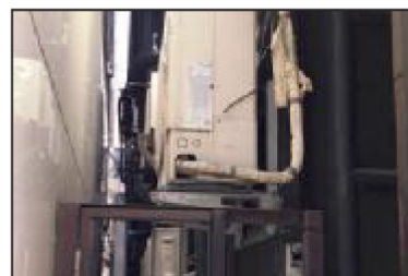
悪い例 (空間を確保していない)
