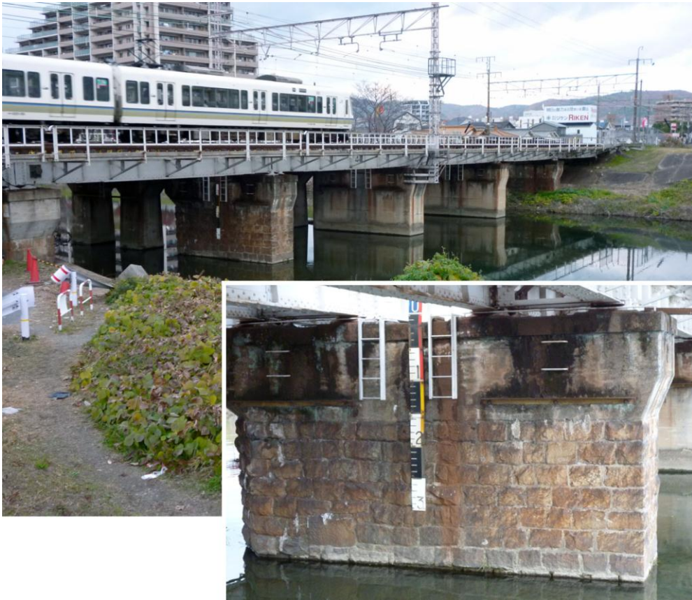
芥川にかかるJR鉄橋の橋脚に高槻城の石垣の石が転用されています。
