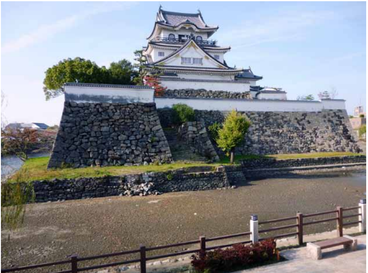
向かって右側の石垣のピンク色に見える石は、修復に使用した薄茶色の花崗岩です。現在も、周庭帯の石垣が一部崩れているのが見えます。
