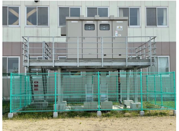
架台の上に設置された受変電設備
