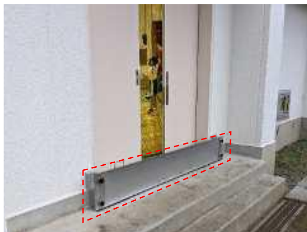
屋内運動場の出入口に設置された止水板
