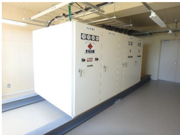
校舎内に設置された受変電設備
