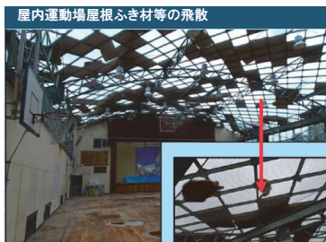
屋内運動場屋根ふき材等の飛散
