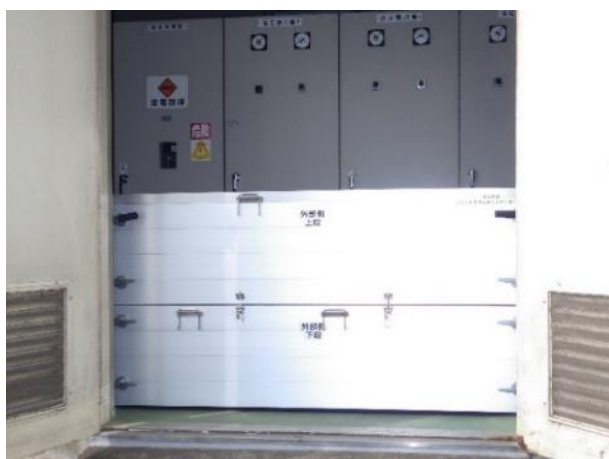
電気室の入口に設置された止水板
