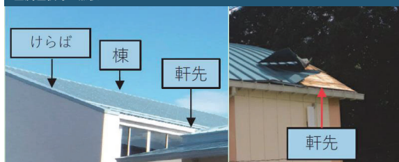
体育館等の金属屋根は、専門業者（製品供給業者、専門工事業者、設計事務所等）により、定期的な点検を実施することが重要。台風などの強風により金属屋根に被害がある場合、軒先・けらば・棟などに集中して被害が発生。
