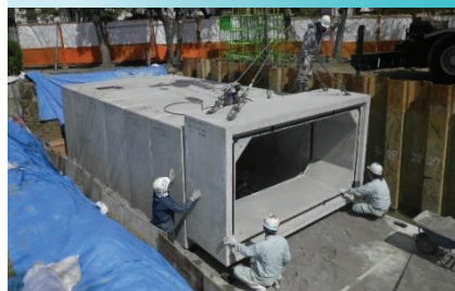
校庭地下に雨水貯留槽を設置し、短時間の局地的な大雨の際に、学校敷地内や近辺への雨水流出を抑制する
